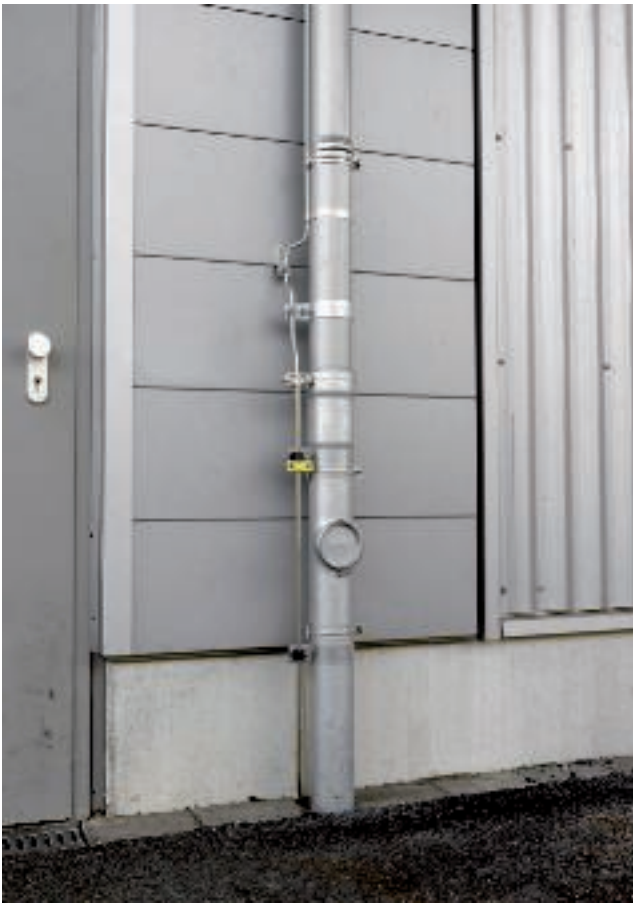
Bleskový svod na odpadní dešťové trubce
