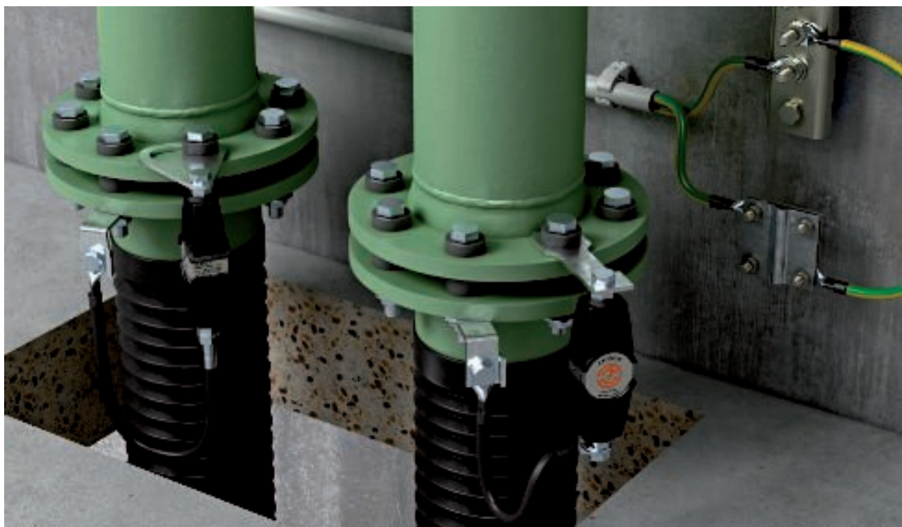
Oddělovací jiskřiště namontované na izolační díly
