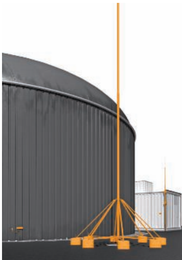
Teleskopické jímací stožáry – použití v bioplynové stanici
