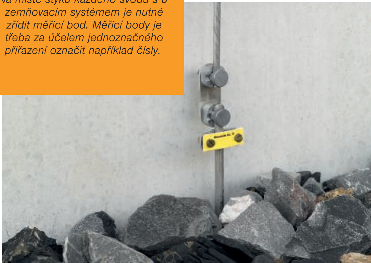
Měřicí bod na uzemňovacím přívodu
